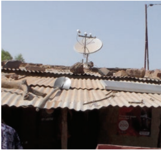
Des antennes paraboliques et des mats de transmission de téléphonie mobile font leur apparition dans les villes et villages du Mali
